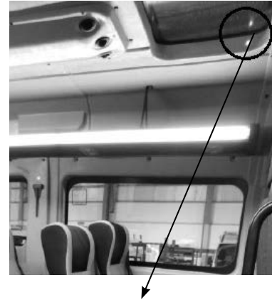
Luces de emergencia de la escotilla de techo
